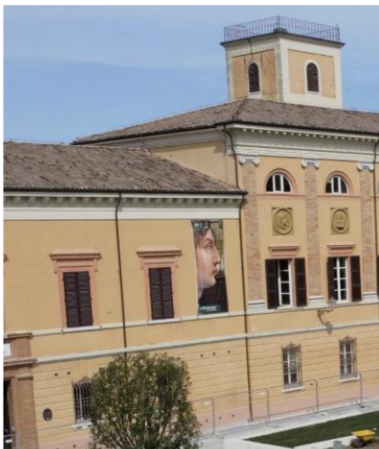
Il tetto della Biblioteca Malatestiana ha subito seri danni a causa di infiltrazioni di acqua piovana (foto Luca Ravaglia)
